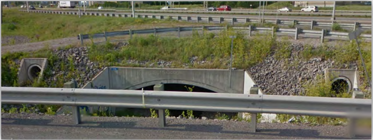
4. Fossé Daigneault à l'angle de la bretelle de l'A10 — Vue en direction Nord (Google 2015, Street View, Juil. 2014).
