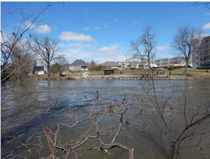
Vue du mur de béton, situé sur la rive nord du pont. Photo prise à partir de la rive sud, à l'est du rail existant, faisant face au nord.
