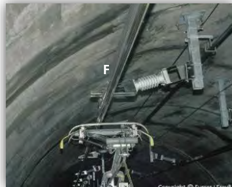
Photographie 7-6 – Profil aérien de contact rigide dans un tunnel
