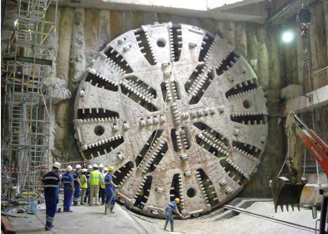
Photographie 6.4.b.- Roue de taille d'un tunnelier. Ligne 9 du métro de Barcelone (Espagne).
