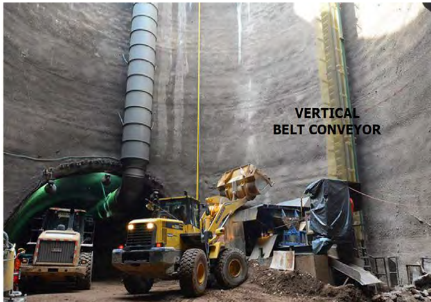
Photographie 8.2.b.- Puits de la ligne L-6 du Métro de Santiago de Chili équipé avec un convoyeur à bande verticale.
